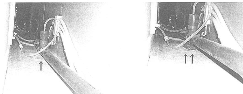
図6 塩ビ廃液配管走行の歪み部分
