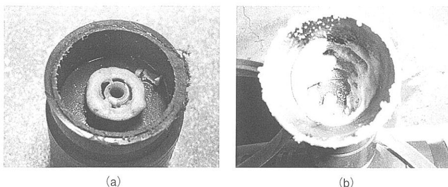
図1 シリコン廃液ライン末端部と塩ビ廃液配管内に付着した有機物 シリコン廃液ラインが短く直角に切断されており、その周囲に付着物が観察された (a)。 塩ビ廃液配管内では廃液が跳ね返る場所に、付着物が観察された (b)。
