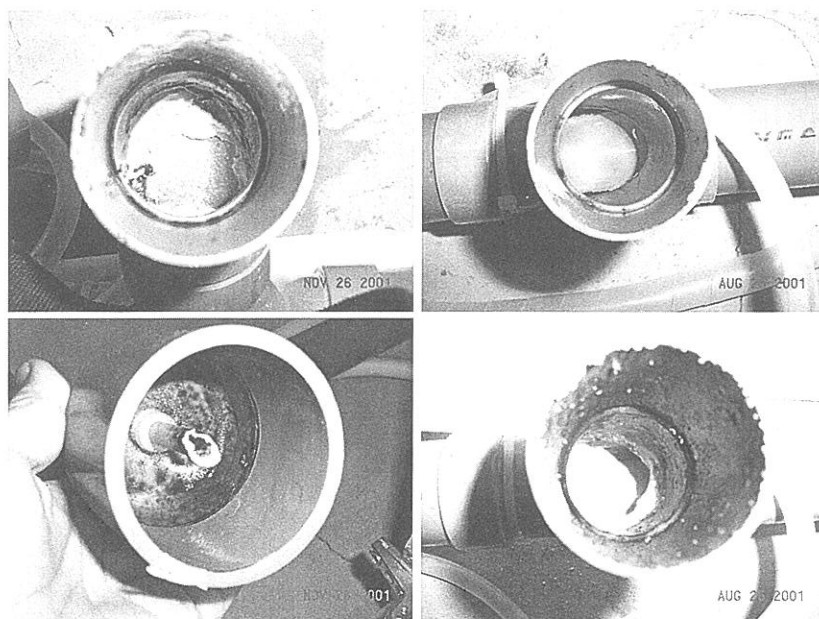
図7 配管洗浄10ヵ月後の廃液配管内部
