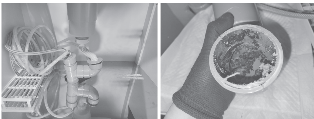
図2 排水配管と泥用物質による排水配管閉塞
