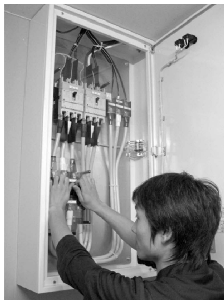
図5 自家発電装置起動訓練の様子 (自家発電切り替え)
